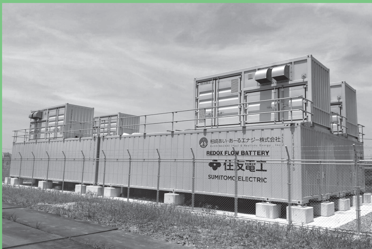
8時間容量レドックスフロー電池(柏崎市) 写真提供:住友電気工業株式会社
